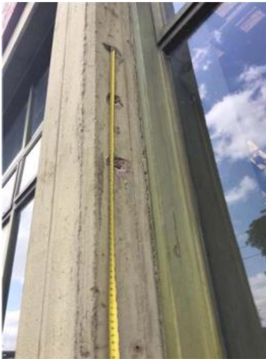
Fotografía N° 32 – Desprendimiento de Recubrimiento
