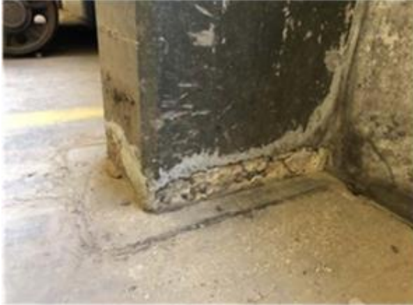
Fotografía N° 25 – Desprendimiento en Columnas
