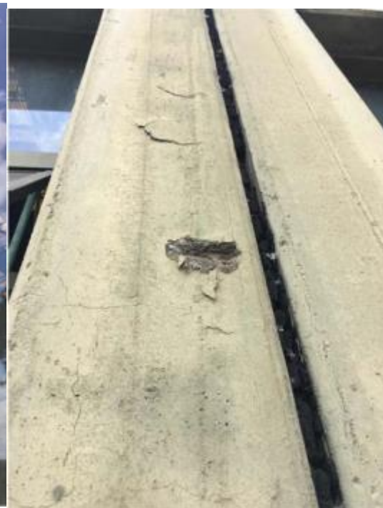
Fotografía N° 31 – Desprendimiento de Recubrimiento
