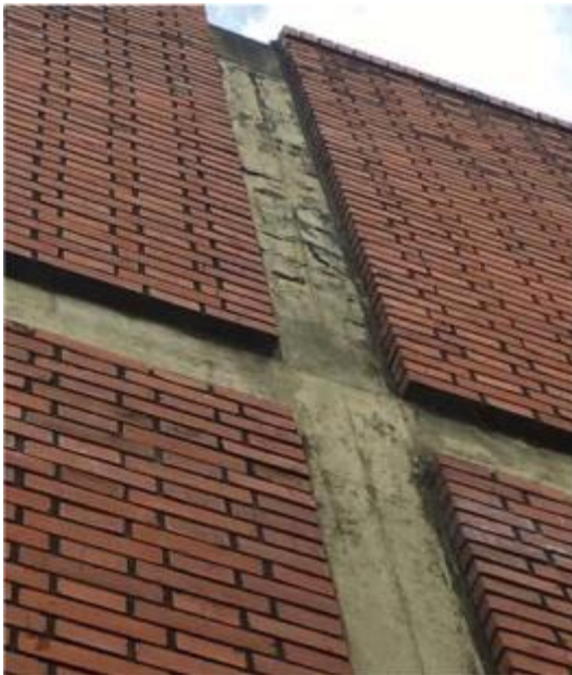
Fotografía N° 27 – Desprendimiento Recubrimiento Columnas Parte Exterior
