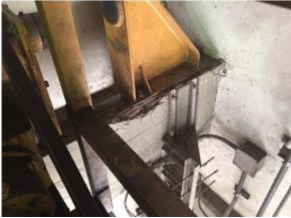
Fotografía N° 21 – Desprendimiento de Material en Viga Carril
