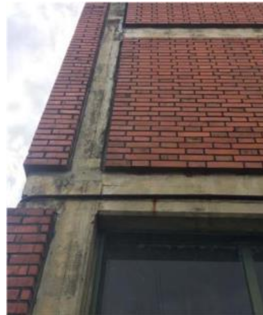
Fotografía N° 28 – Desprendimiento Recubrimiento Columnas Parte Exterior
