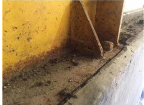
Fotografía N° 22 – Fisura en Viga Carril
