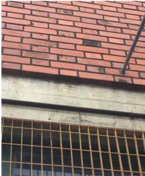
Fotografía N° 29 – Fisura Viga Exterior
