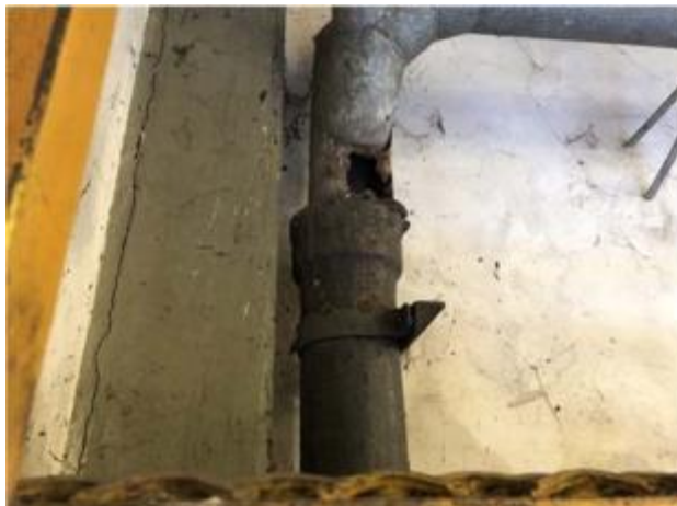
Fotografía N° 23 – Montante Pluvial Existente deteriorado
