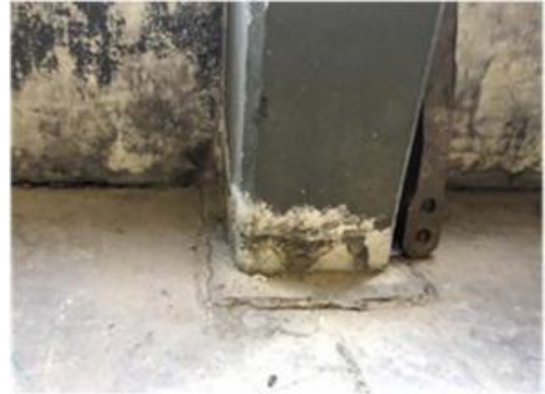
Fotografía N° 26 – Desprendimiento en Columnas
