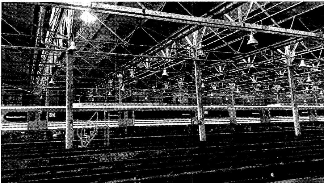
RELEVAMIENTO FOTOGRAFICO - REPARACIÓN DE DESAGÜES PLUVIALES TALLER SUAREZ ETAPA I – LÍNEA MITRE
