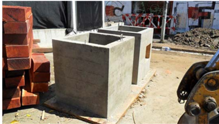
Imagen 5 - Cámara de inspección de referencia
