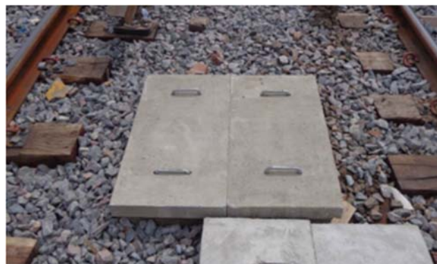
Imagen 6 - Tapa de cámara de inspección
