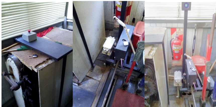
Imágenes de Referencia: Cabín ramal Mitre, dotado de barreras semi automáticas. Se pueden observar pulsador accionamiento de barreras, enclavamiento San Martín y señalización visual de estado de barrera.
