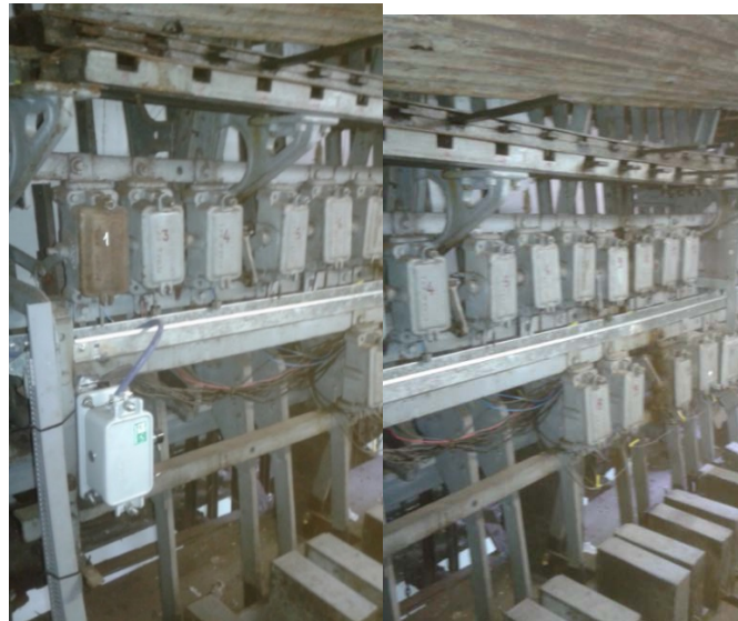
Imágenes de Referencia: Cabín 3- San Martín, sector inferior al cuadro de palancas.
