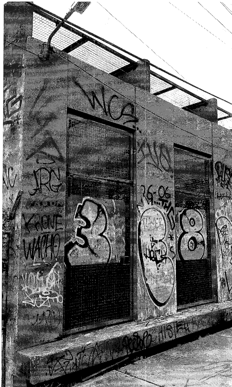
Transformadores en Núñez
