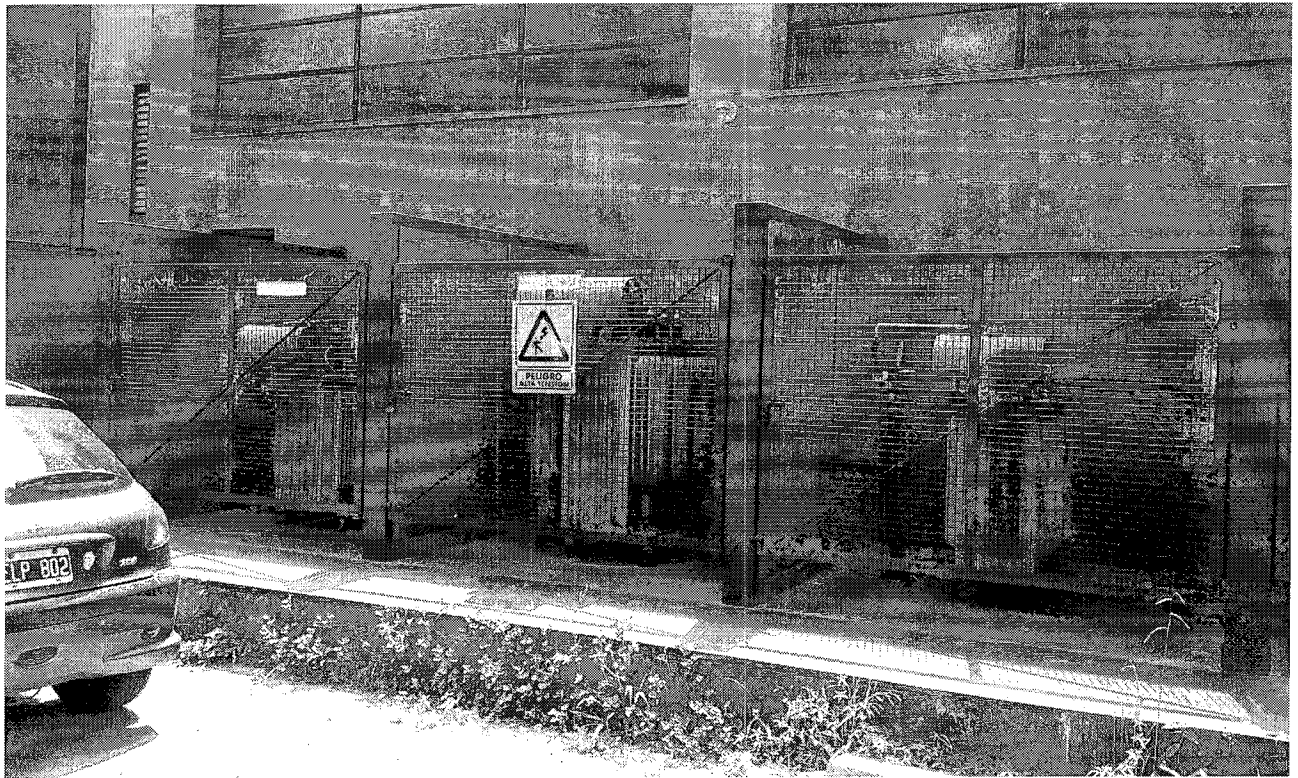
Transformadores en Olivos
