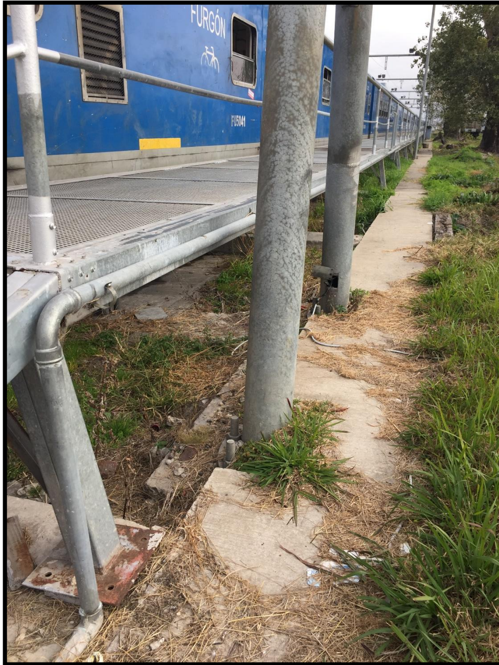
Ilustración 2. Instalaciones de agua y electricidad incompletas
