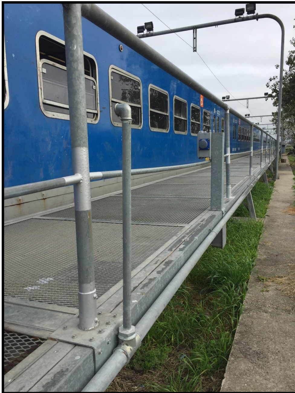
Ilustración 1. Instalaciones de agua y electricidad incompletas
