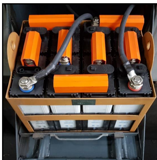
Figura 2 – Imagen de conexionado del cajon de baterías.
