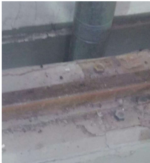
Desprendimientos de los recubrimientos de hormigón
