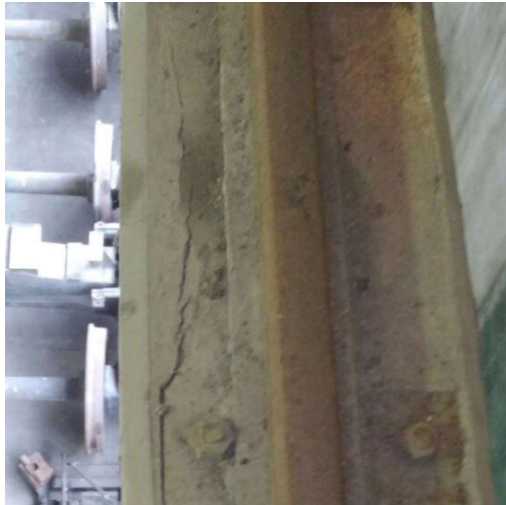
Vista superior de viga, fisura lateral a riel en forma longitudinal.
