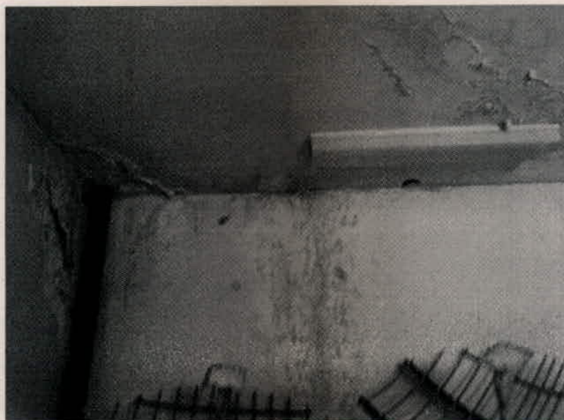
FILTRACIONES EN PAREDES LATERALES Y CUBIERTA
