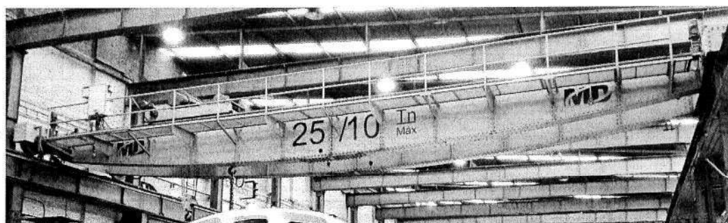
Puente-grúa 1117, ubicado al norte de la Nave 0 del taller mencionado.
