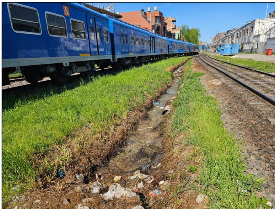
Vista zanja a cielo abierto a entubar. Residuos, acumulación de agua de lluvia contaminada
