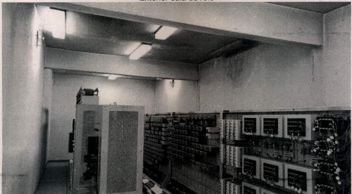
Interior sala de relé – equipos a proteger
