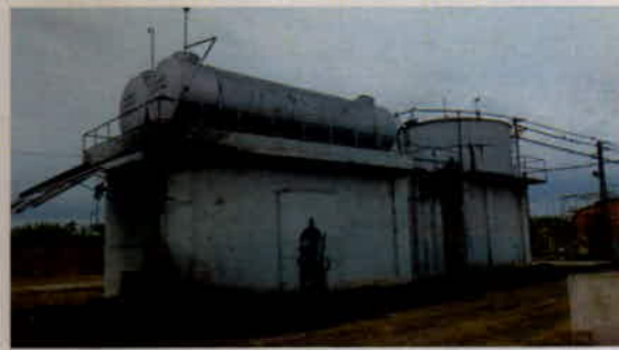
Foto 2 –Tanques de almacenaje de gasoil (80 m 3 ).
