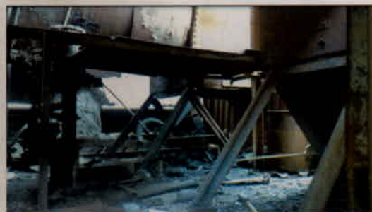
Foto 8 – Instalación de Calderas en Desuso a remover. (Evaluar composición de material aislante)
