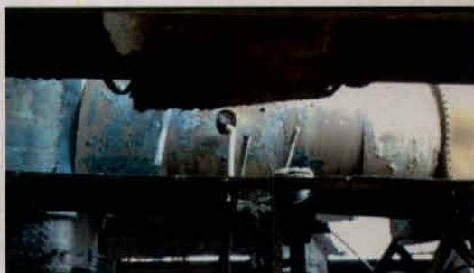
Foto 9 – Instalación de Calderas en Desuso a remover. (Evaluar composición de material aislante)
