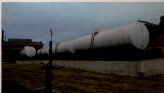
Foto 1 –Tanques de almacenaje de gasoil (150 m 3 ).
