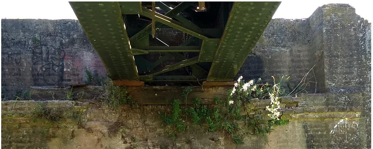
Vista general de falla en estribo
