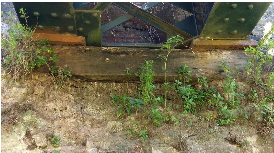
Falta de sustentación en viga de apoyo
