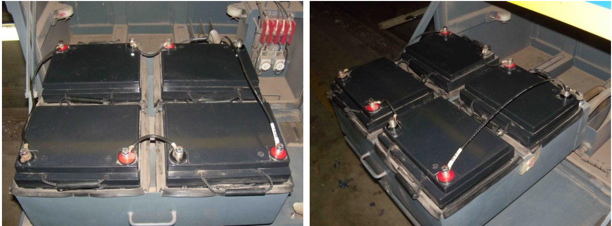
Fotos de instalación de las baterías dentro del compartimiento caja bajo piso.
