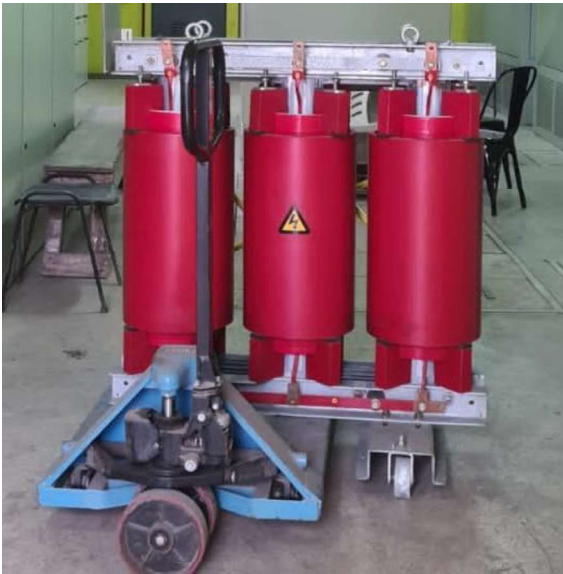
Figura 2. Transformador seco encapsulado a reparar
