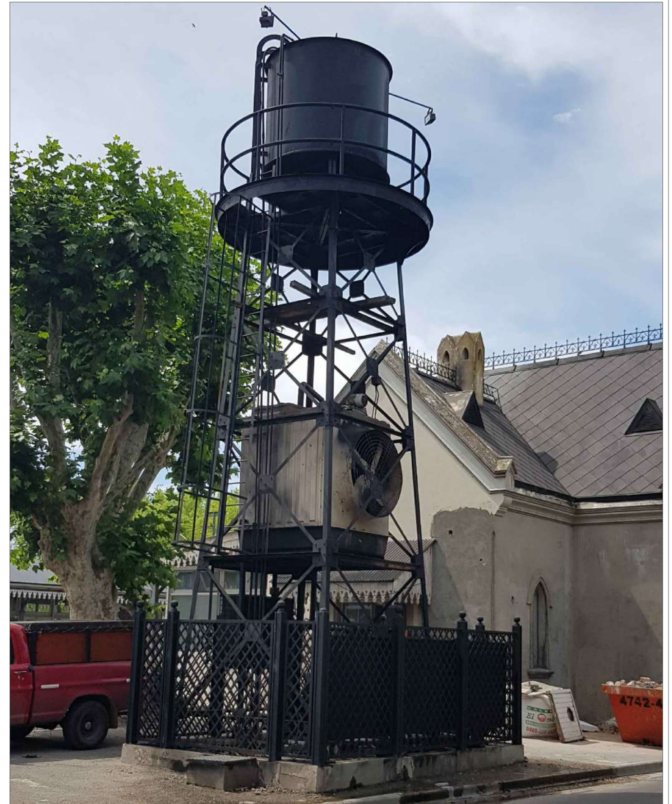
TANQUE DE RESERVA
