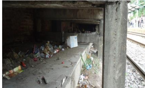
Cánalización bajo andén alto
