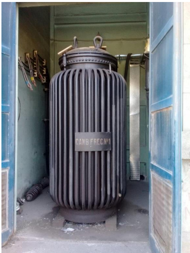
Figura 1. Cubicle de transformador actual a retirar y colocar nuevo transformador.
