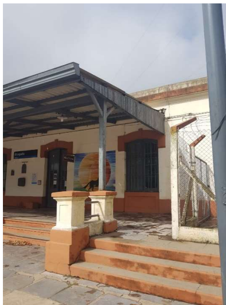
Imagen N°7 - Cubierta a reemplazar.
