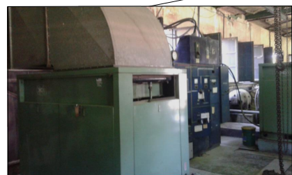
Interior de la sala de Compresores.
