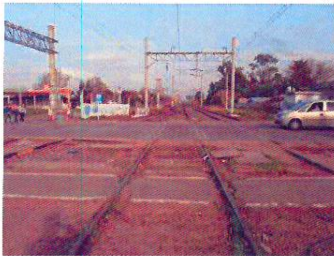
Foto 25: Calzada vehicular en mal estado
