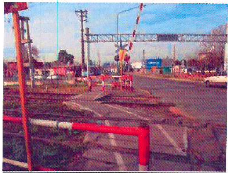
Foto 22: Pasillo peatonal y laberintos fuera de norma.
