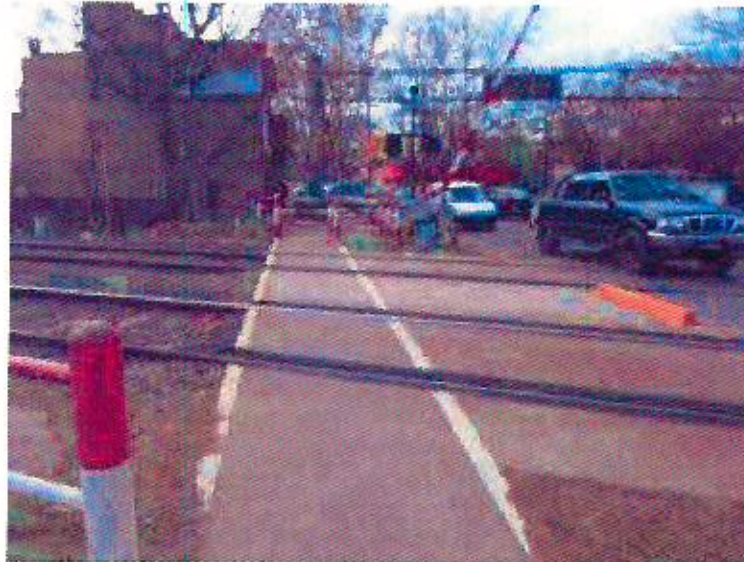
Foto 8: Pasillo peatonal y laberintos fuera de norma.
