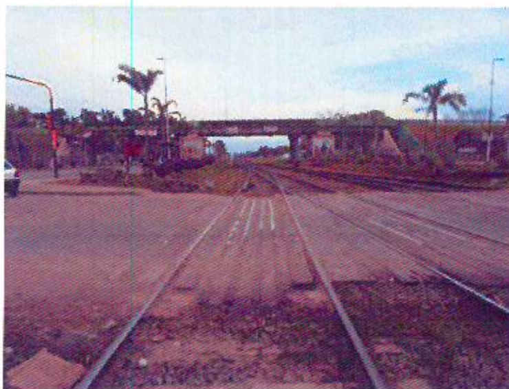
Foto 40: Estado de la calzada.
