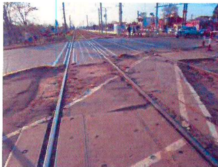
Foto 20: Pasillo peatonal y laberintos fuera de norma.
