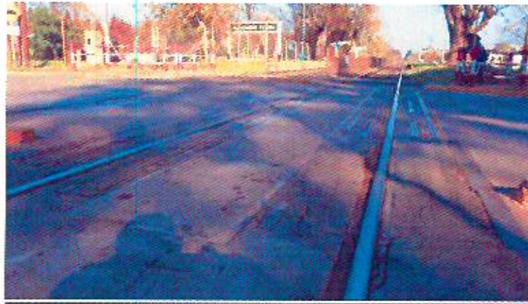
Foto 43: Calzada vehicular en mal estado
