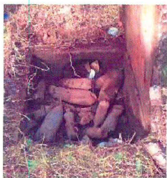
Foto 35: Estado actual del sistema de drenaje de vía.
