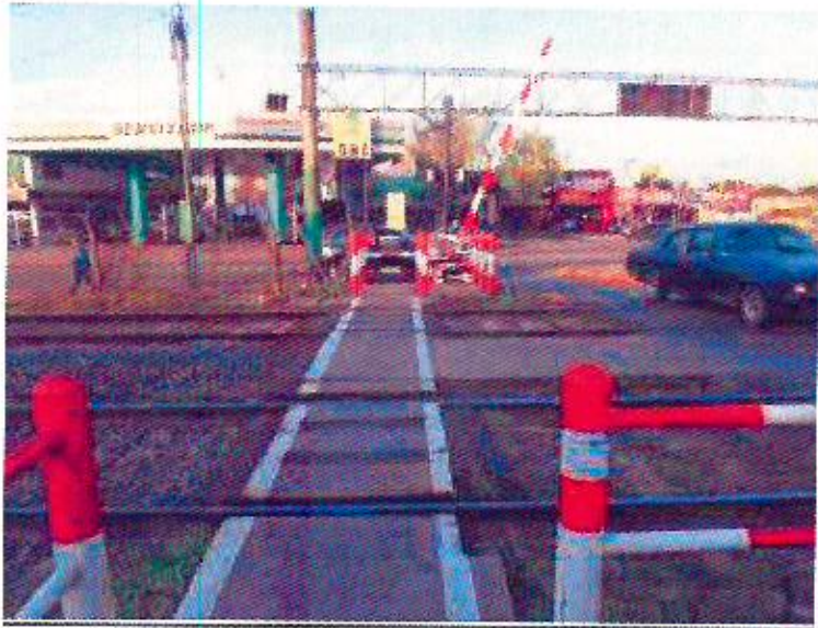
Foto 12: Pasillo peatonal y laberintos fuera de norma.
