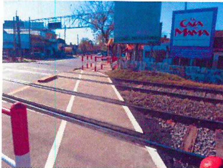
Foto 4: Pasillo peatonal y laberintos fuera de norma.
