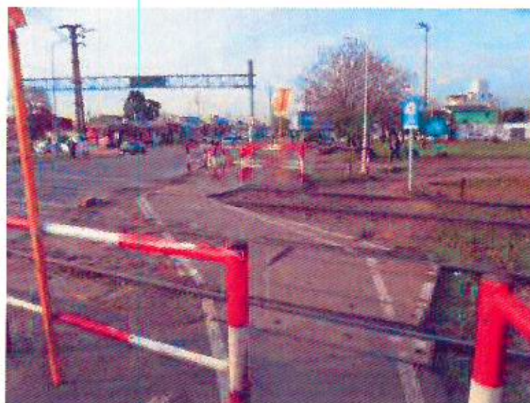
Foto 21: Pasillo peatonal y laberintos fuera de norma.
