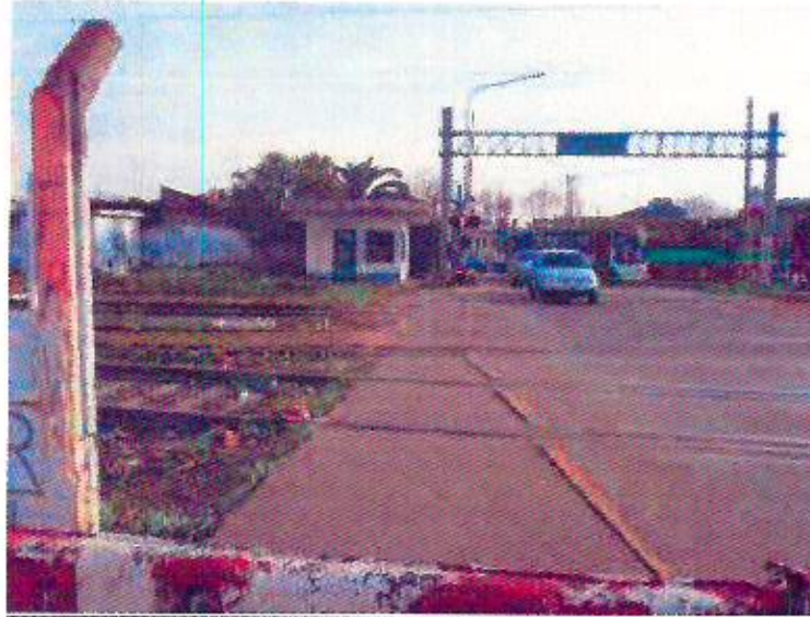
Foto 26: Pasillo peatonal y laberintos fuera de norma.
