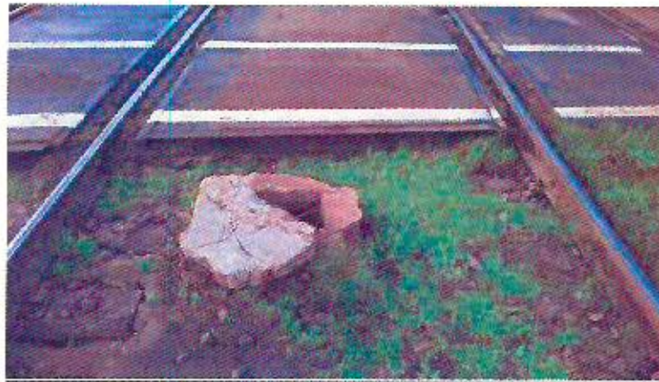
Foto 32: Calzada vehicular y losa de aproximación en mal estado.
