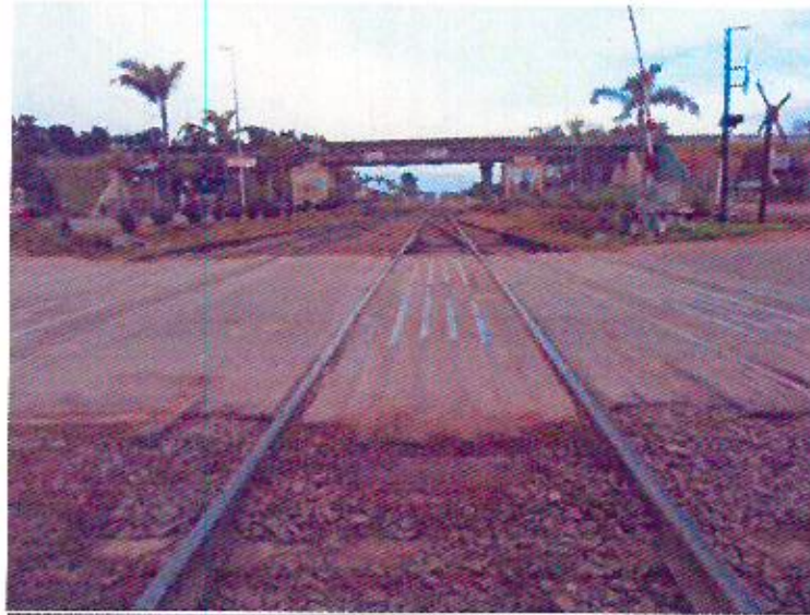
Foto 41: Estado de la calzada.
