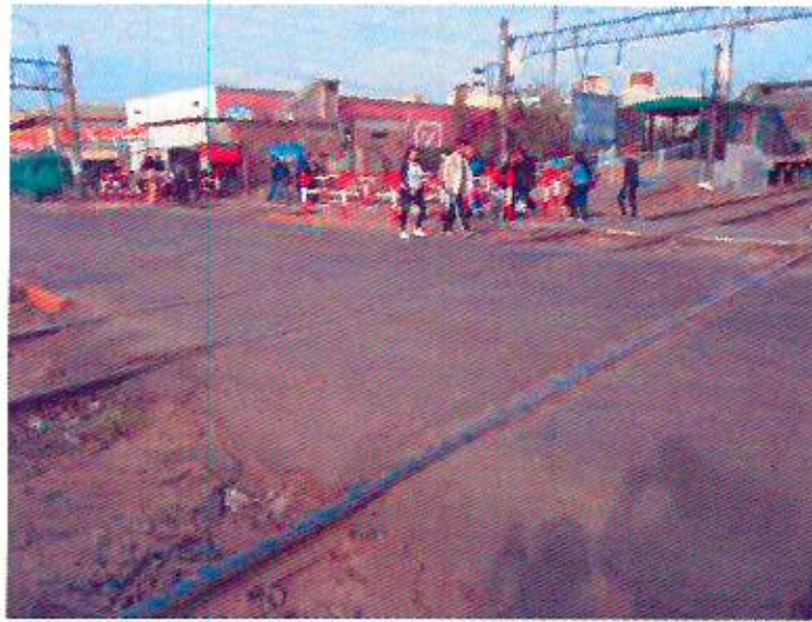
Foto 17: Calzada vehicular en mal estado.
