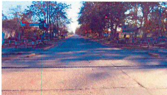
Foto 46: Estado de losas de aproximación y de entre vías.
