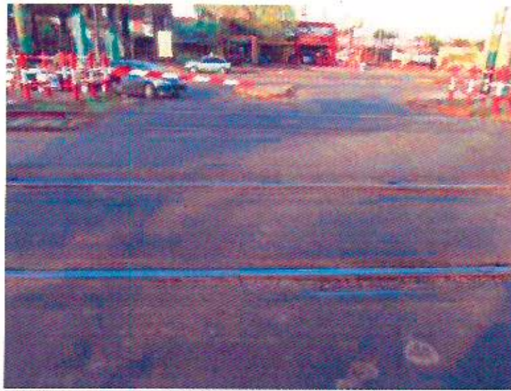
Foto 10: Calzada vehicular en mal estado.
