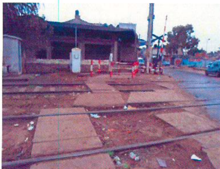
Foto 49: Pasillo peatonal y laberintos fuera de norma.
