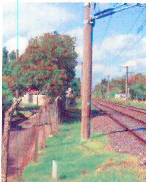
Foto 51: Mojón indicando línea de 13,2 kV enterrada y poste de catenaria energizada a 25 kV.
