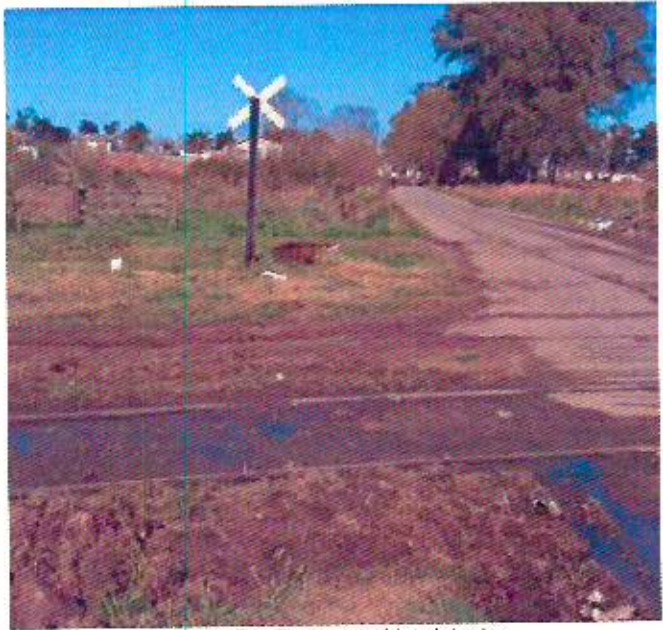
Foto 7: Pasillo peatonal inexistentes.
