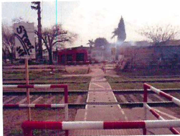
Foto 35: Pasillo peatonal inexistentes.
