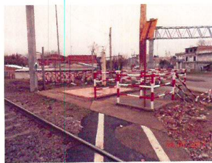
Foto 3: Pasillo peatonal y laberintos fuera de norma.
