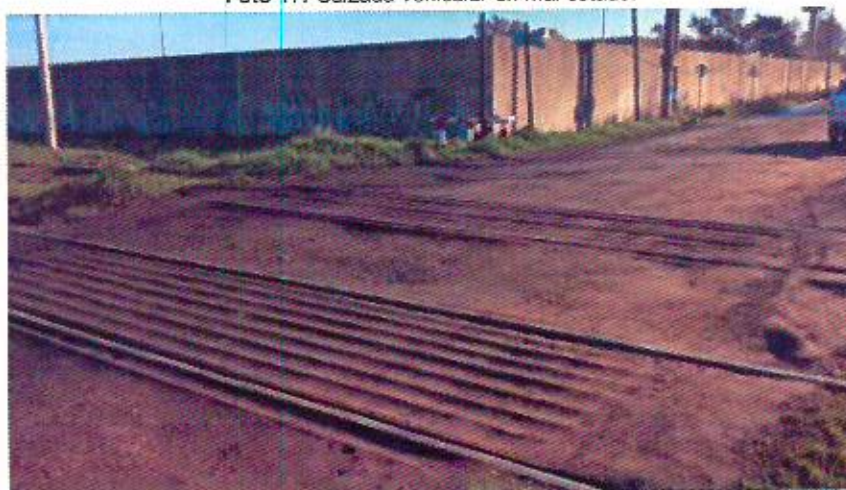
Foto 18: Calzada vehicular en mal estado.
