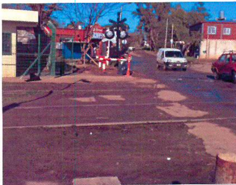
Foto 12: Pasillo peatonal y laberintos fuera de norma.
