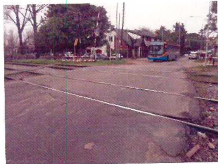
Foto 67: Calzada vehicular en mal estado.
