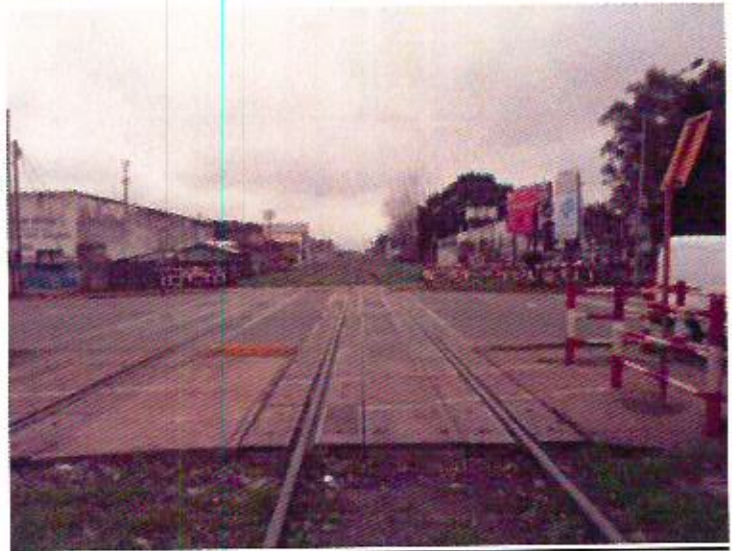
Foto 56: Calzada vehicular y losa de aproximación en mal estado.
