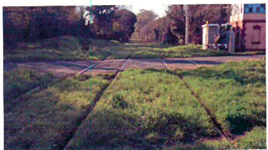
Foto 20: Calzada vehicular en mal estado.
