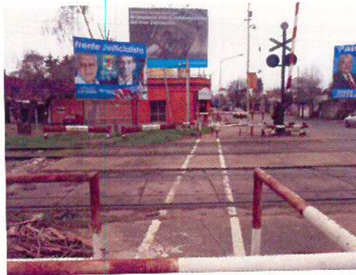
Foto 70: Pasillo peatonal y laberintos fuera de norma.
