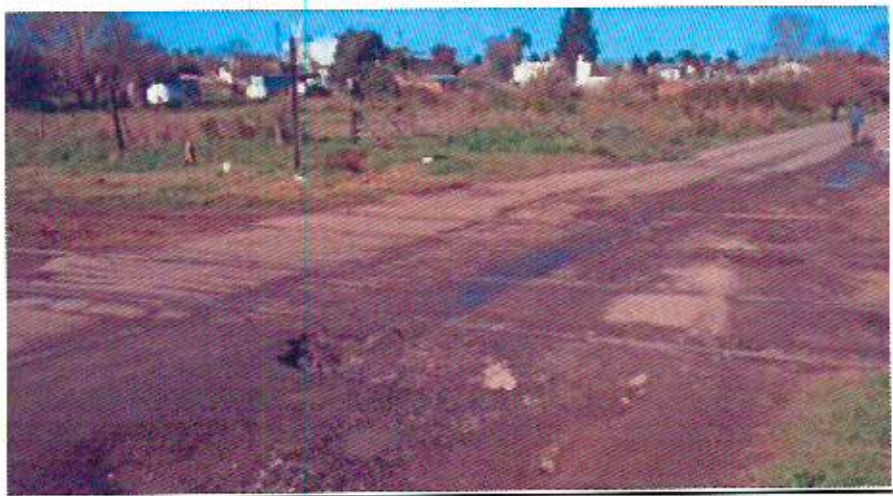
Foto 6: Calzada vehicular y losa de aproximación en mal estado.
