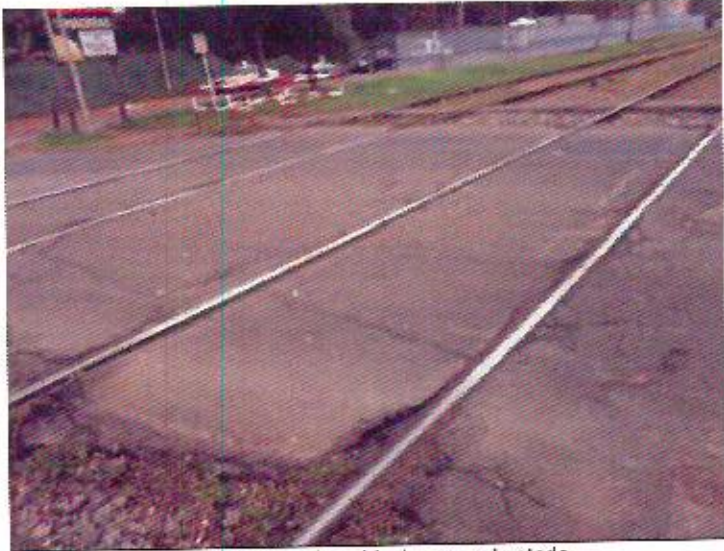
Foto 66: Calzada vehicular en mal estado.
