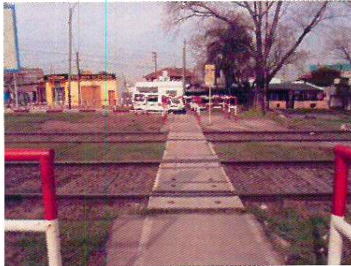
Foto 36: Pasillo peatonal inexistentes.
