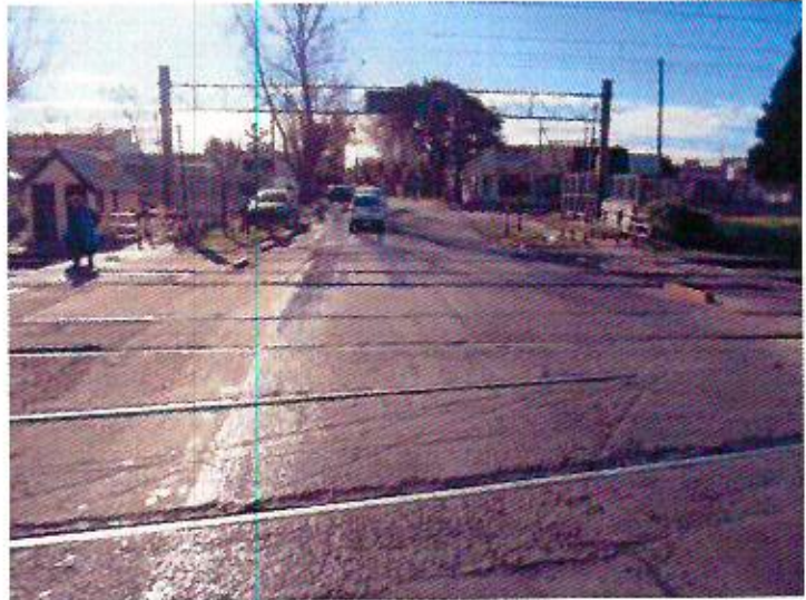
Foto 32: Pasillo peatonal y laberintos fuera de norma.
