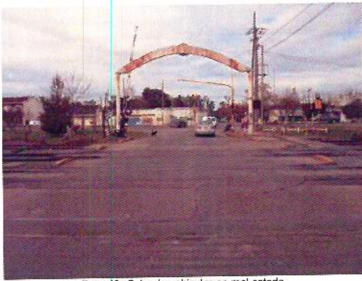
Foto 48: Calzada vehicular en mal estado.
