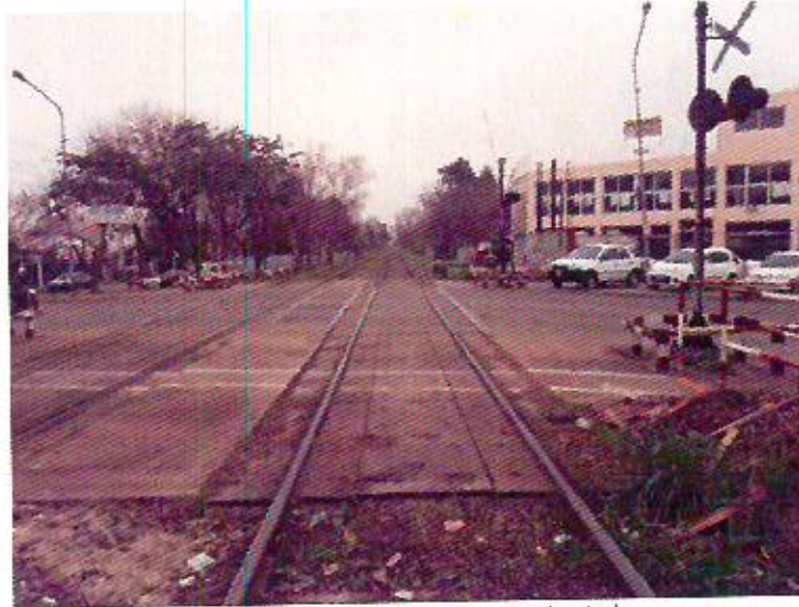
Foto 69: Calzada vehicular en mal estado.
