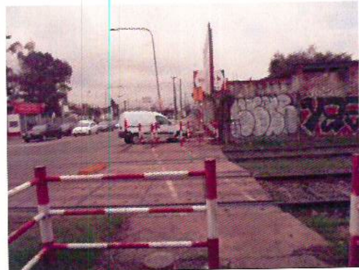
Foto 57: Pasillo peatonal y laberintos fuera de norma.
