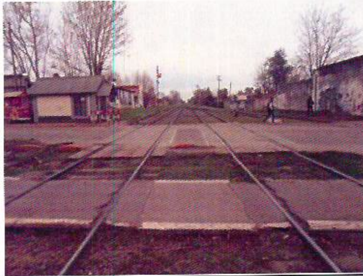
Foto 45: Calzada vehicular en mal estado.
