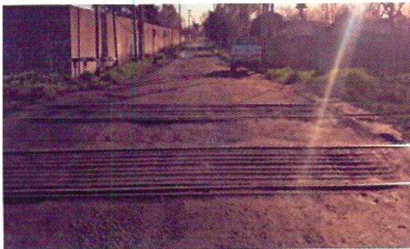
Foto 17: Calzada vehicular en mal estado.
