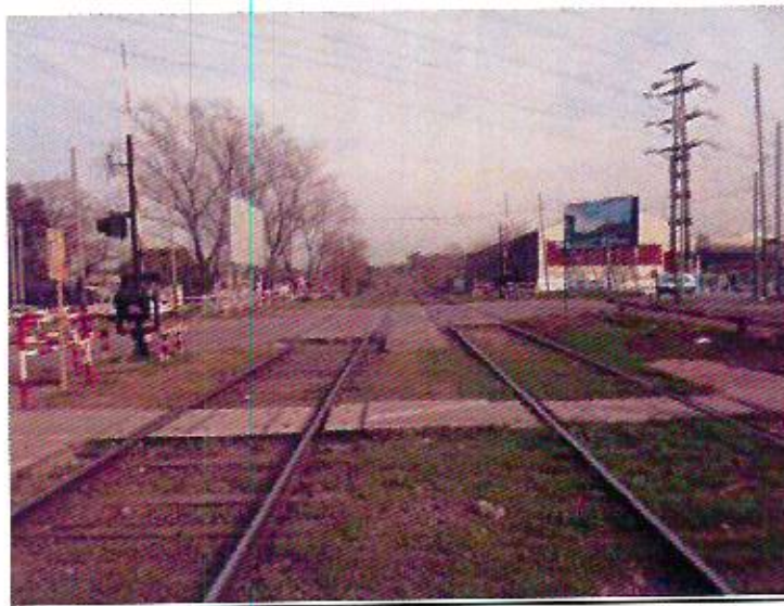
Foto 34: Calzada vehicular y losa de aproximación en mal estado.
