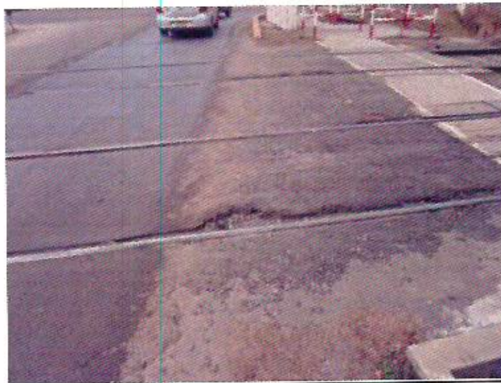
Foto 38: Calzada vehicular en mal estado.
