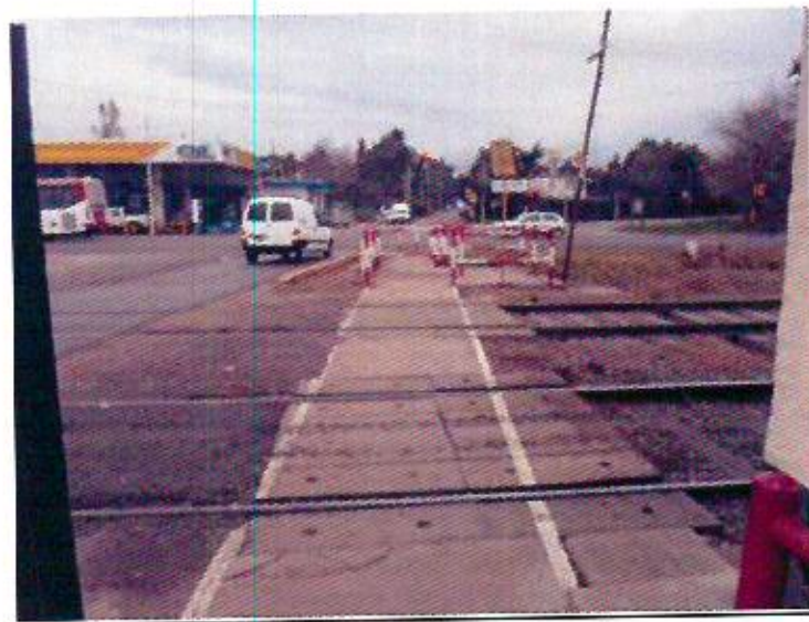
Foto 39: Pasillo peatonal y laberintos fuera de norma.
