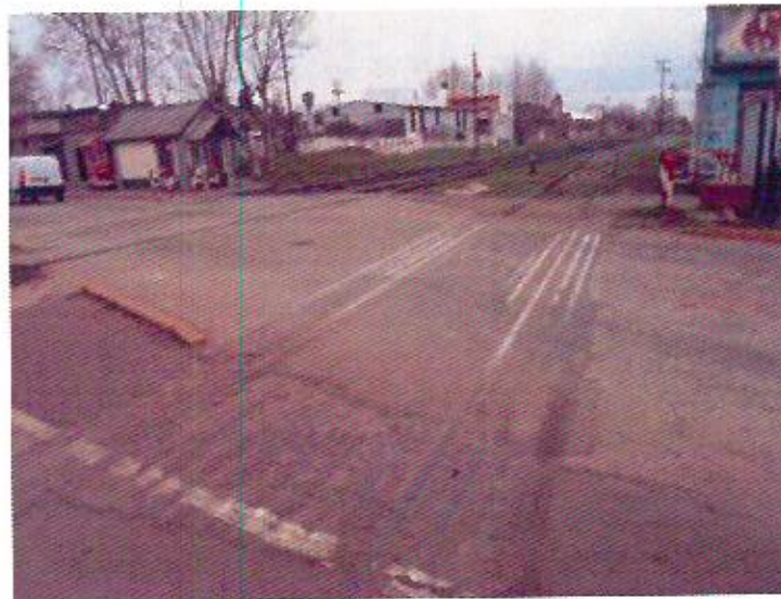
Foto 46: Calzada vehicular en mal estado.
