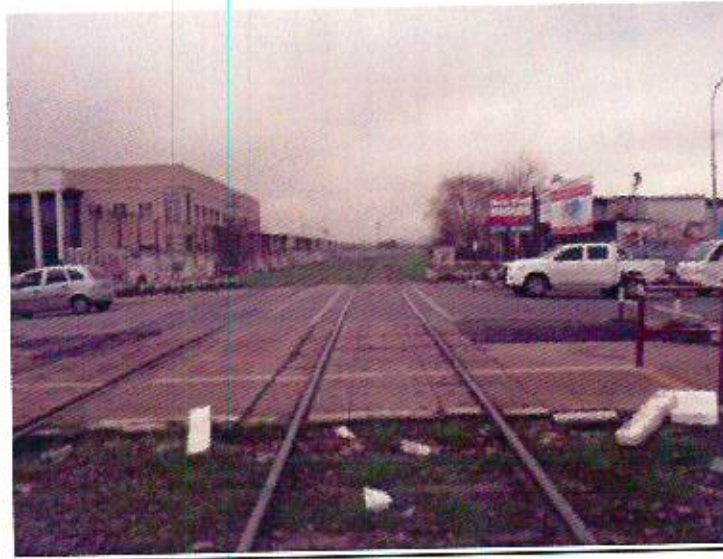
Foto 60: Calzada vehicular en mal estado.
