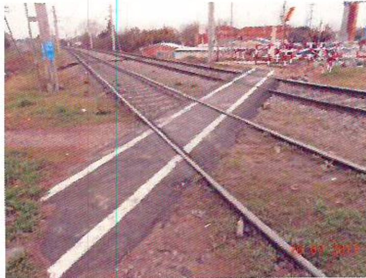
Foto 4: Pasillo peatonal y laberintos fuera de norma.
