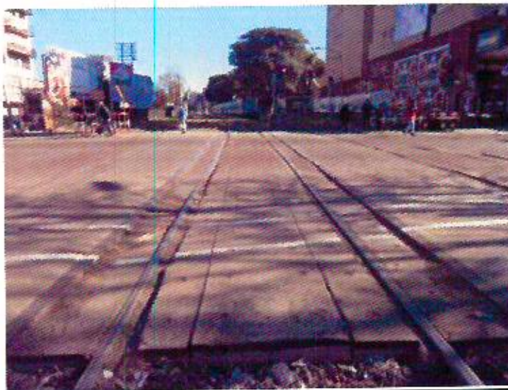
Foto 74: Calzada vehicular en mal estado.
