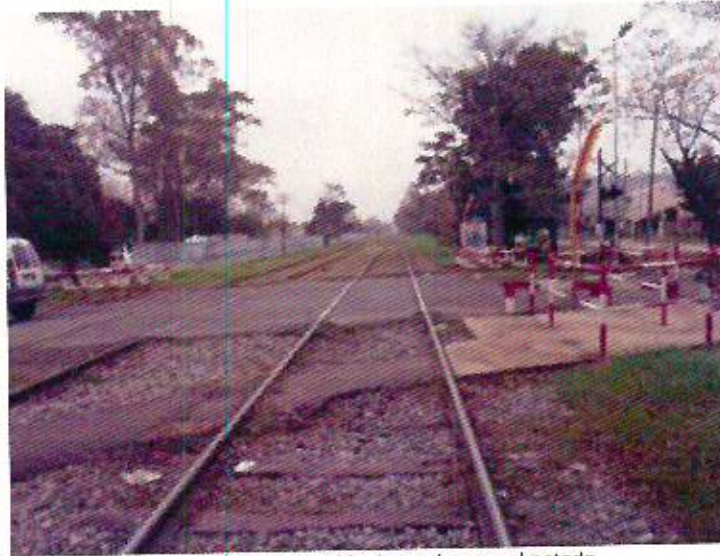
Foto 64: Calzada vehicular y vía en mal estado.
