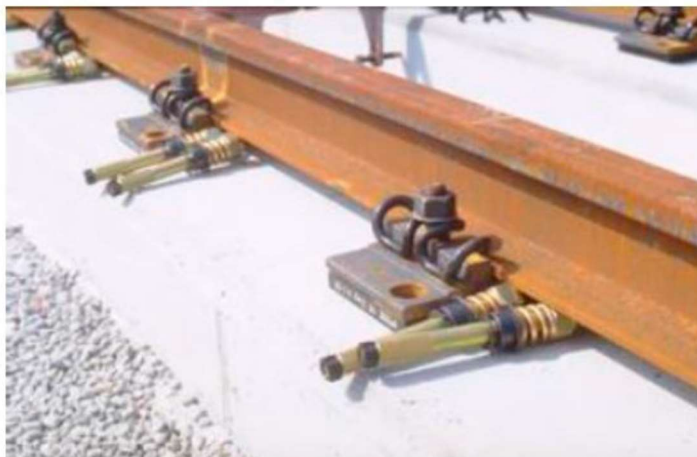
Imagen: Placa de fijaciones de vías.
