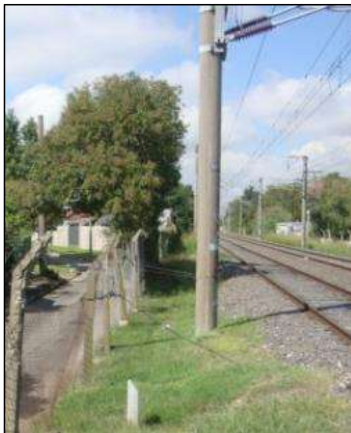
Mojón indicando línea de 13,2 kV enterrada y poste de catenaria energizada a 25 kV.
