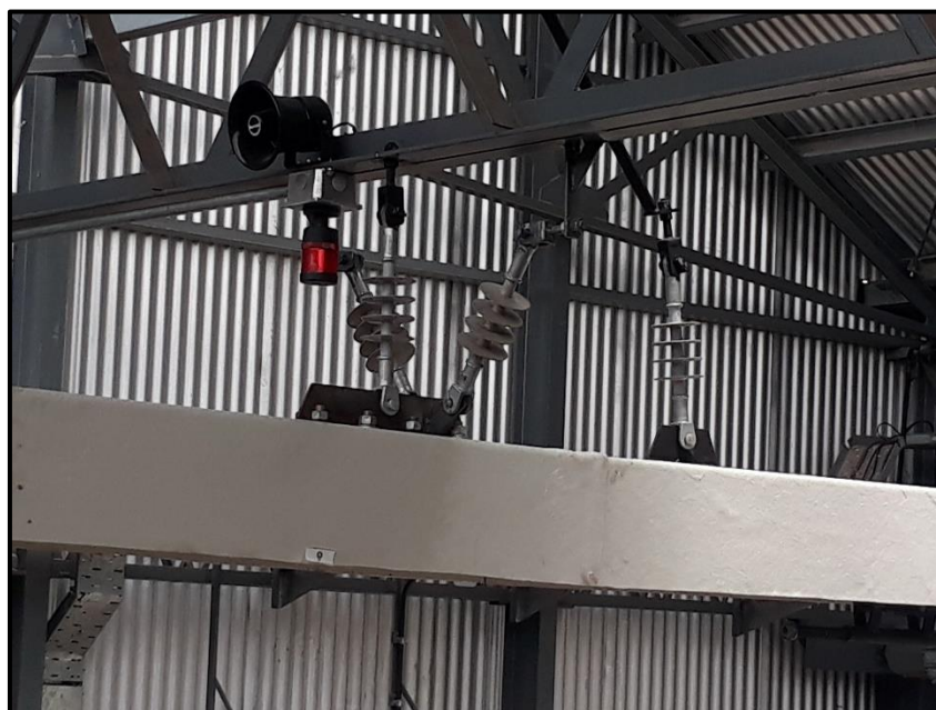
Figura 3. Otro ejemplo de los anclajes del tercer riel aéreo.
