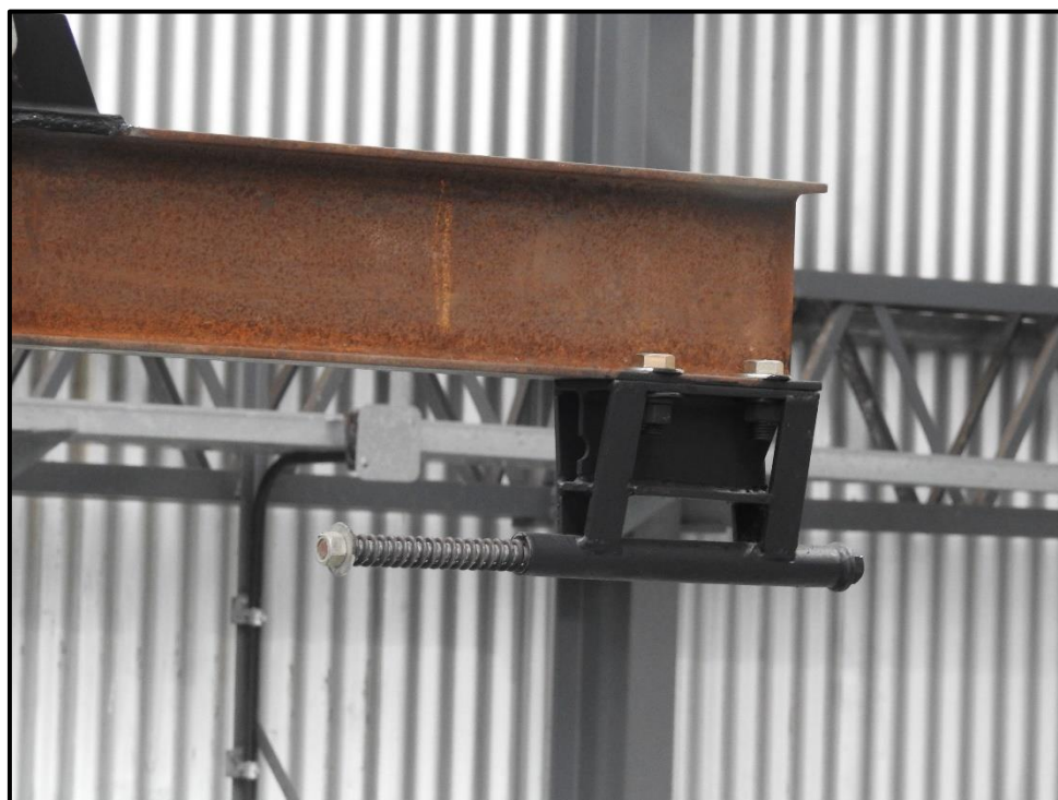
Figura 5. Sistema de amortiguación en fines de tercer riel.
