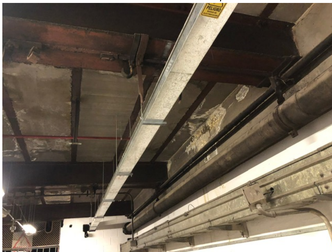
Sectores de Subsuelo con humedades por filtraciones
