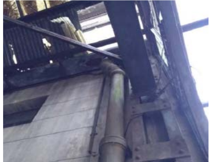
Sistema Pluvial existente Cubierta Andenes 15
