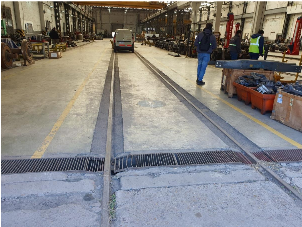
Espacio con bitumen desgastado a ser relleno con bitumen asfáltico.
