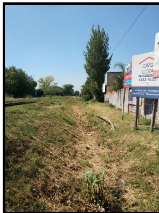
Ilustración 2. PAN Necochea lado Retiro. Zanja seca, debido a obstrucción
