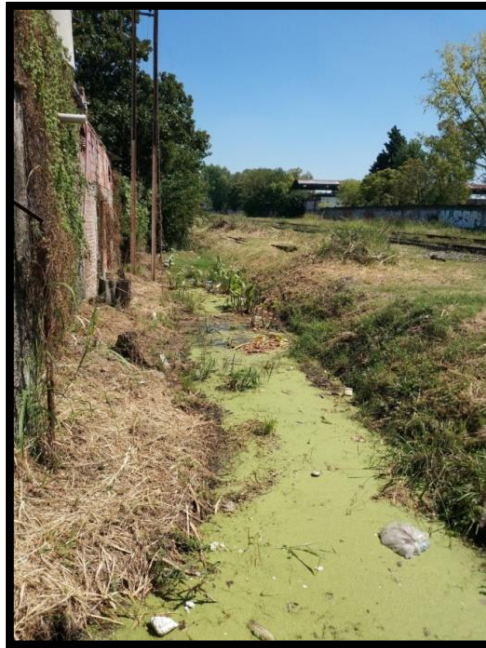
Ilustración 5. PAN Ocampo lado Dr. Cabred. Inundación por obstrucción
