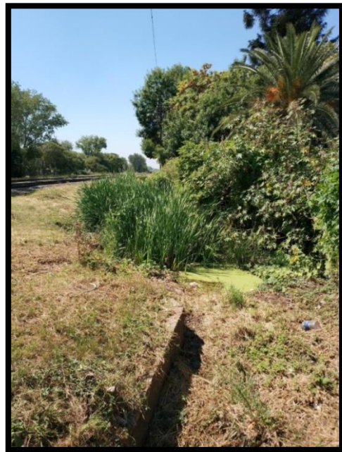
Ilustración 6. PAN Ocampo lado Retiro. Plantas obstruyendo zanja
