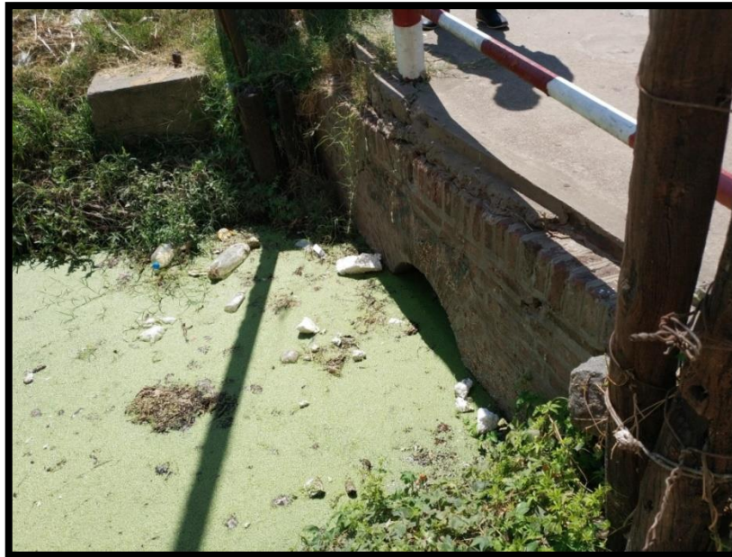
Ilustración 7. Caño de pase bajo PAN Ocampo. Obstruido, generando falta de desagote
