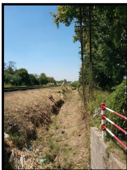
Ilustración 10. PAN Gral. Rodríguez lado Retiro. Zanja seca pero con suciedad y obstrucciones. Al fondo el Arroyo Morón
