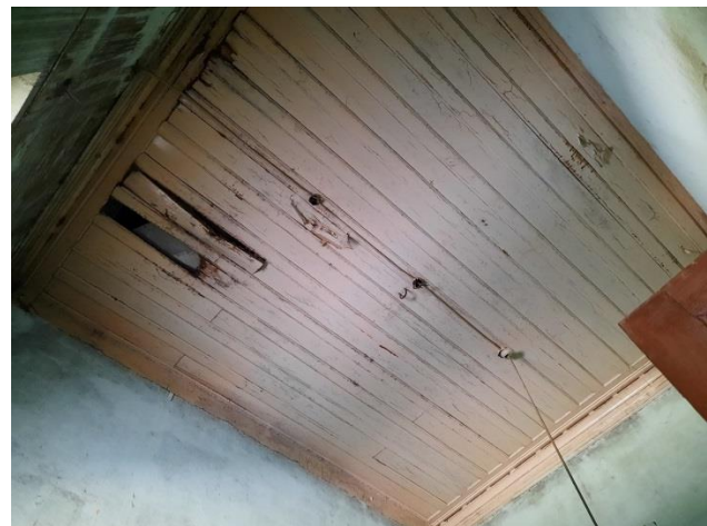
Cielorraso deteriorado y caído
