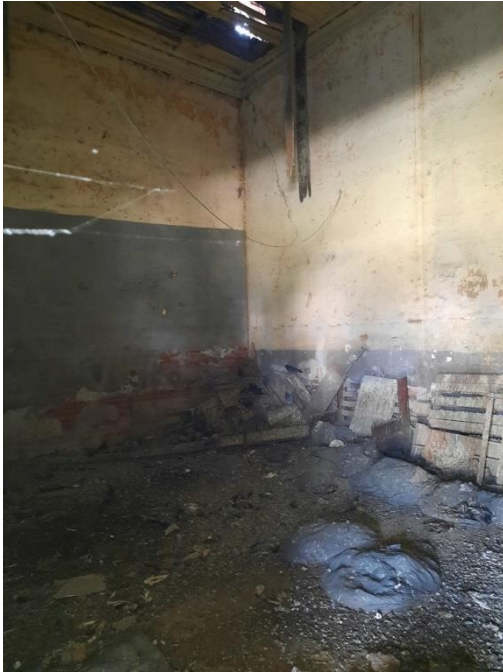
Local con techo caído e invadido por alimañas
