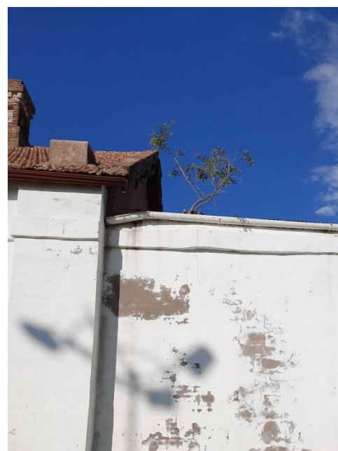
Contrapiso sobre losa en mal estado - plantas
