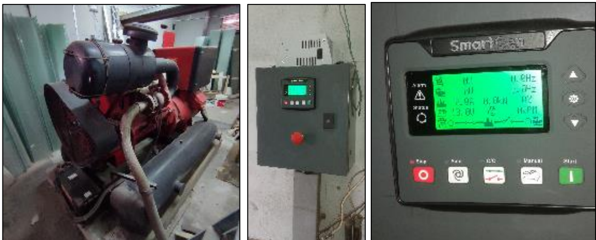
Grupo electrógeno e interface de mando.
