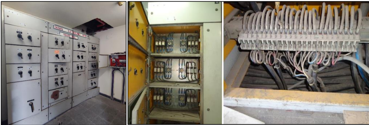
Fotografías TGBT-1 (A retirar y reemplazar). Detalle borneras conexas, fusibles y llaves seccionamiento.
