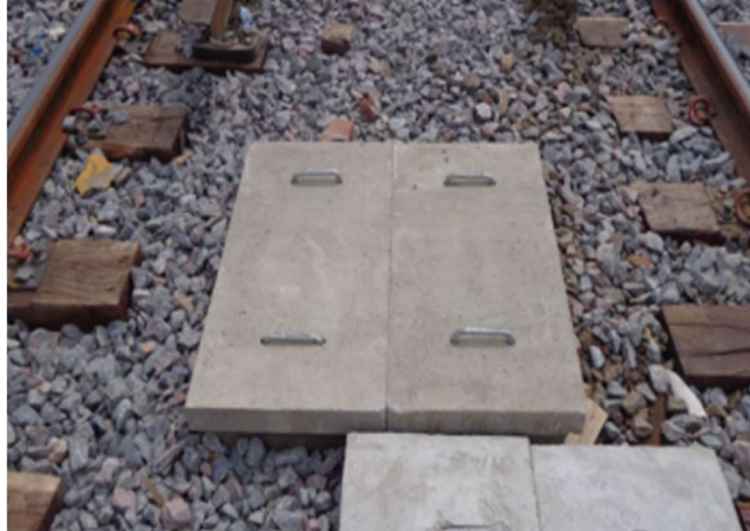
Tapa de cámara de inspección
