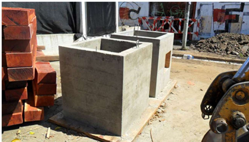
Cámara de inspección de referencia
